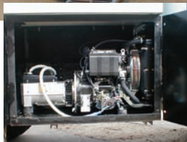
Электроагрегат АДА8-230РЛ установлен под кунгом на вахтовых вездеходах для обслуживания газопроводов
